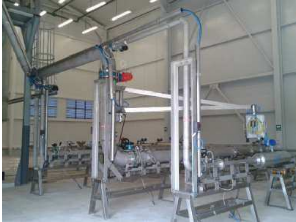
Fig. 4 Tanque báscula, válvula diverter
